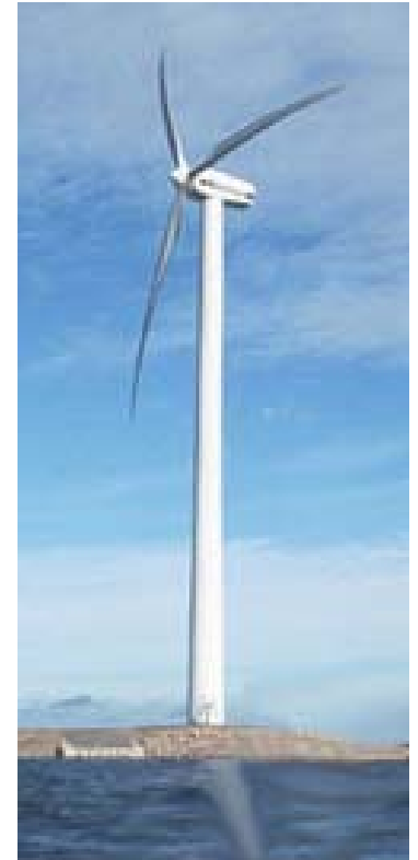
Lumituuli Ab:s kraftverk vid Lumijoki producerar vindkraftsel till elnätet.
